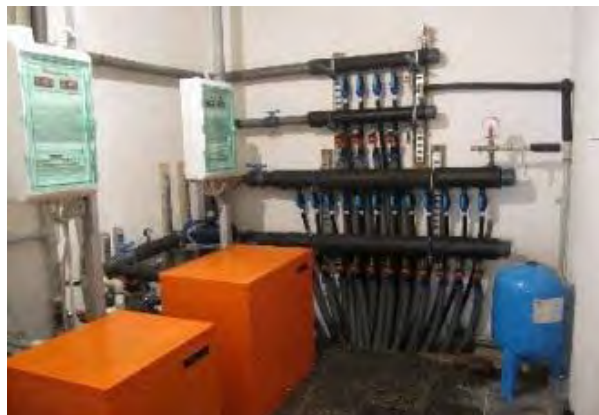
ТНУ и щиты управления
