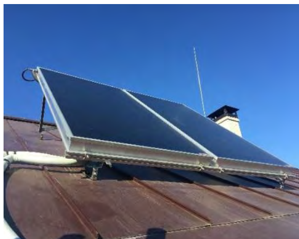
Солнечная панель на крыше дома
