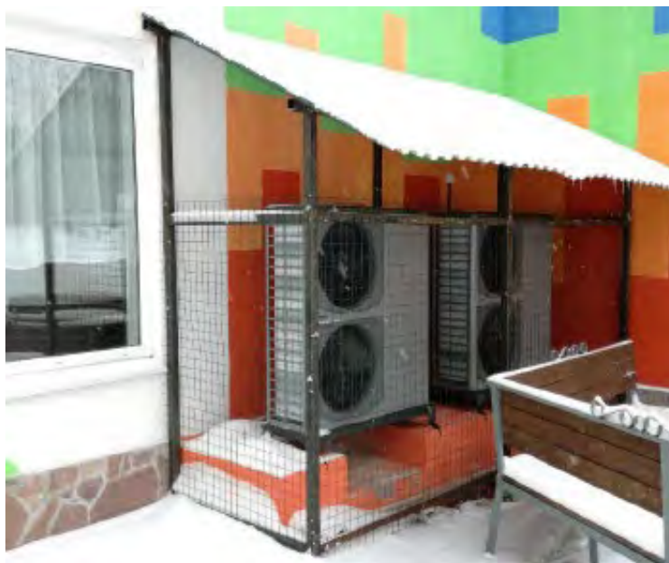
Внешние блоки тепловых насосов
