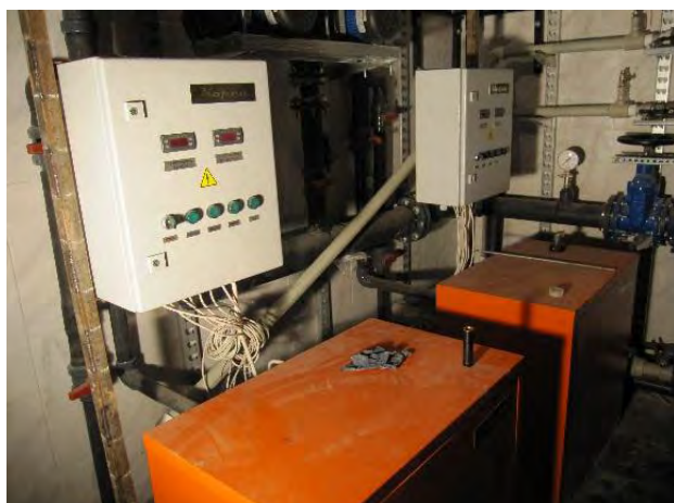
ТНУ и щиты управления
